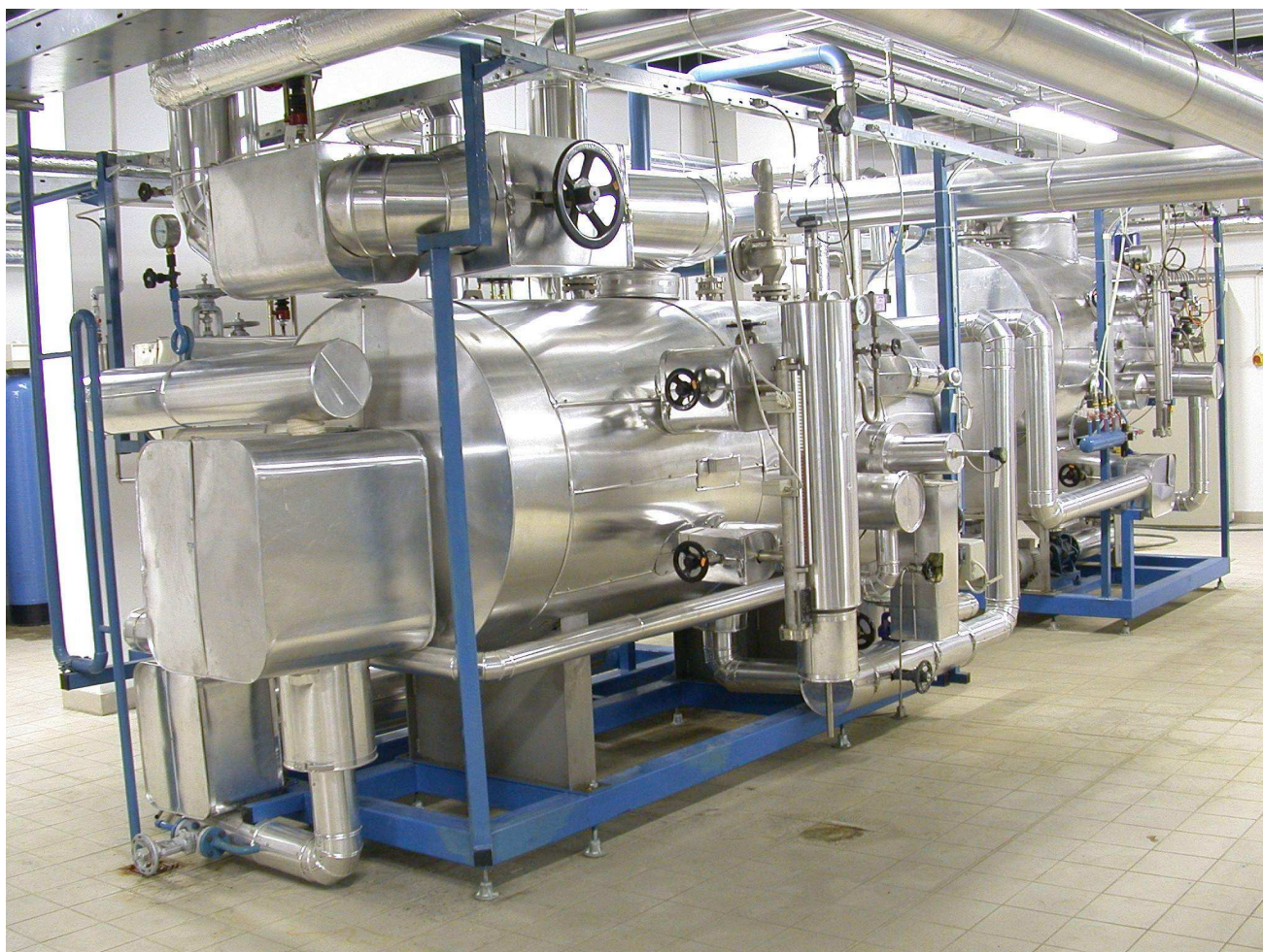
Obr. 2 Odparka čisté páry – technické zázemí centrální sterilizace
